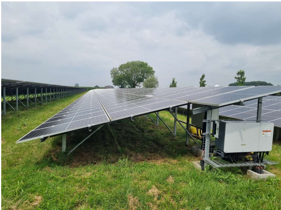
Figur 13. Solceller med 'fixed tilt' samt växelriktare.
