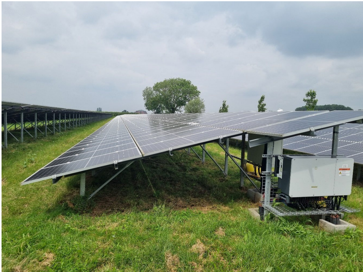
Figur 107 Solceller med 'fixed tilt' samt växelriktare
